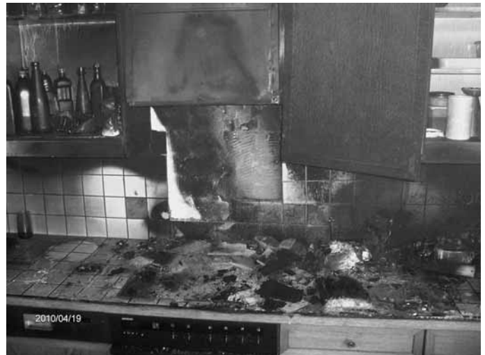
Bild der ausgebrannten Küche nach den Löscharbeiten.
