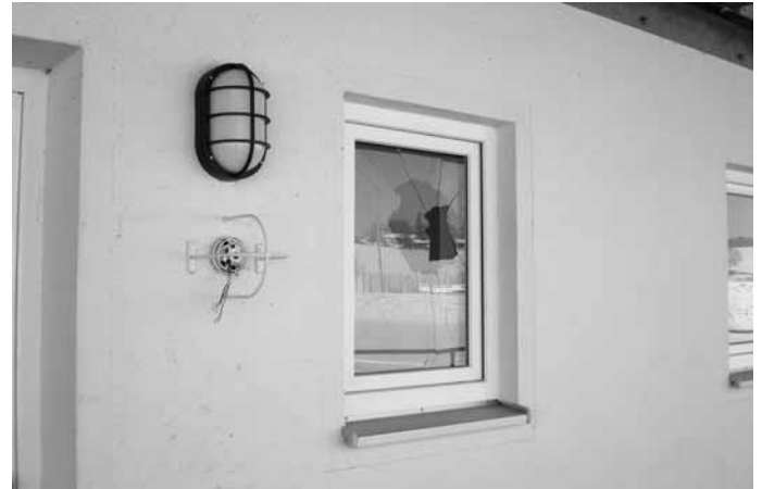
Das eingeschmissene Toilettenfenster, durch das der/die Einbrecher in den Kabinentrakt gelangten.
